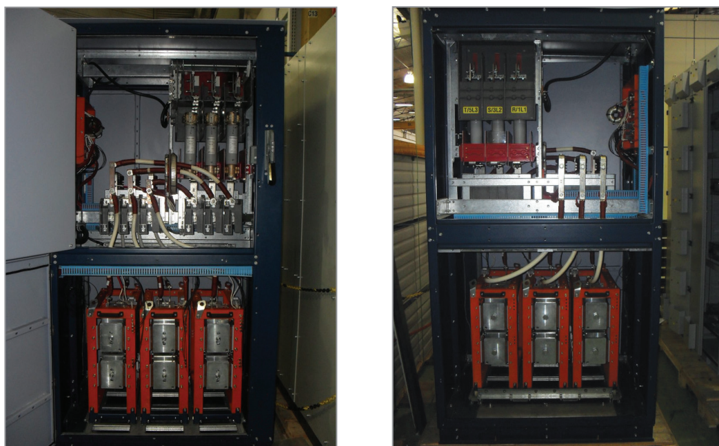
Figura 5.5 (a): Compartimento de média tensão (frente e verso) - IP41
