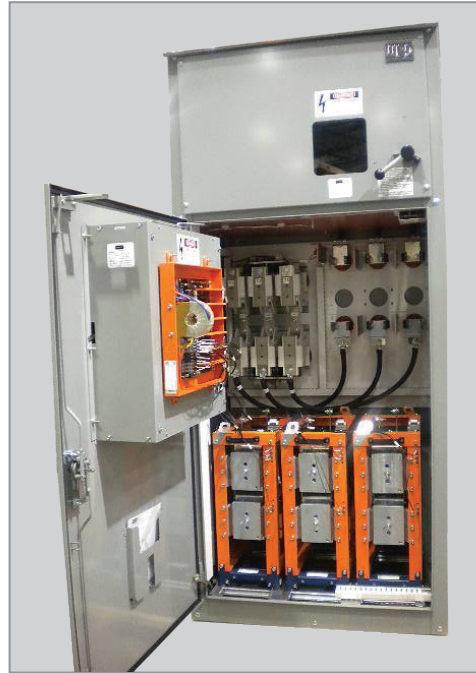
Figura 5.5 (b): Compartimento de média tensão (frente) - Nema 12
