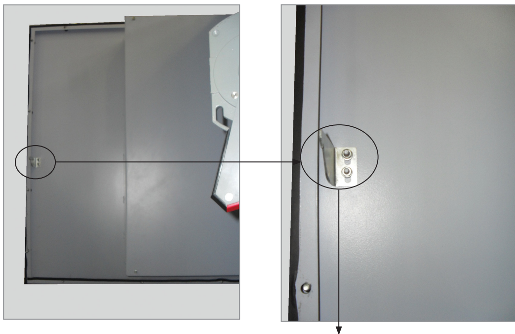
Parafusos de ajuste do travamento da porta do compartimento de média tensão
